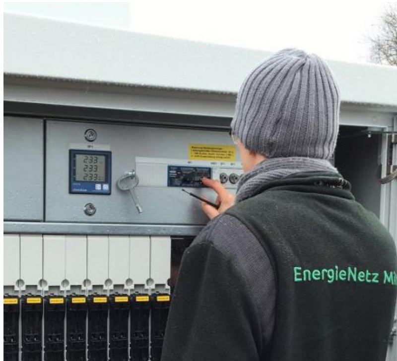
Netzanschluss für den Solarpark in Gladenbach-Weidenhausen (Foto: 7x7energie)
