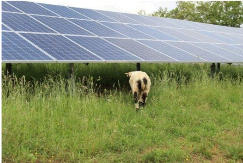
Schafe halten das Gras kurz auf den Solarparkflächen wie hier in Greifenstein (Mittelhessen).
