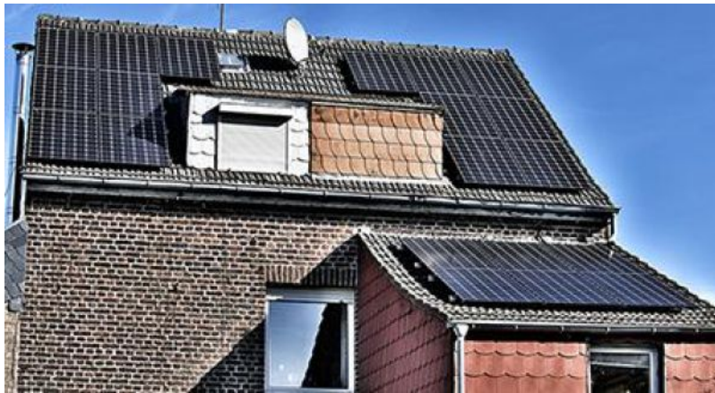
Mit einer PV-Anlage auf dem Dach kann der Sonnenstrom kostenlos getankt werden. © Holger Bernert
