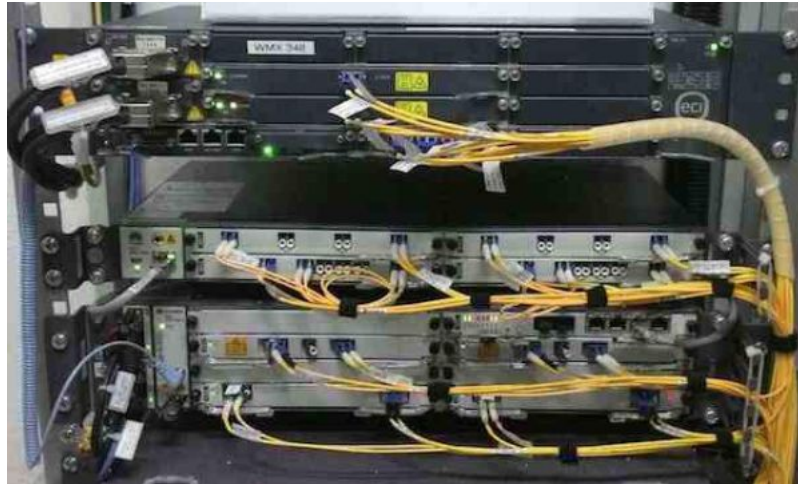
BG 64 SDH Multiplexer aus dem Hause ECI Telecom.
