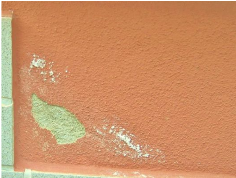
Ach kleine Schäden sollten schnell und fachmännisch beseitigt werden
