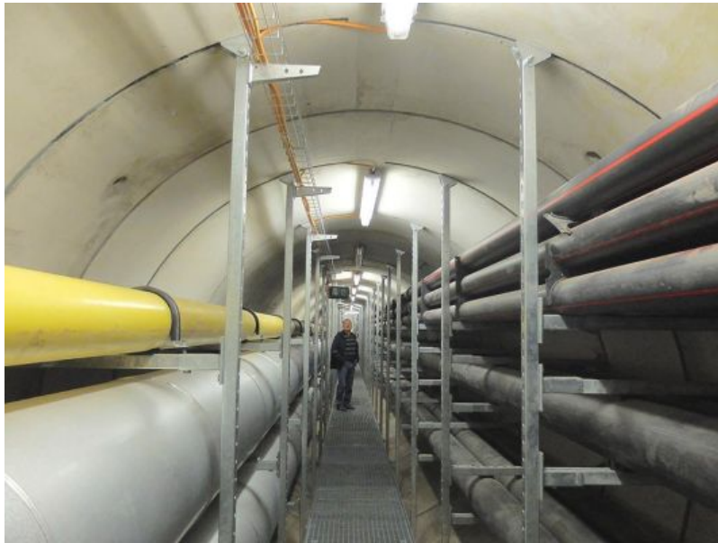
Der Stahlbeton-Kanal ermöglicht eine übersichtliche Bündelung unterschiedlichster Medien
