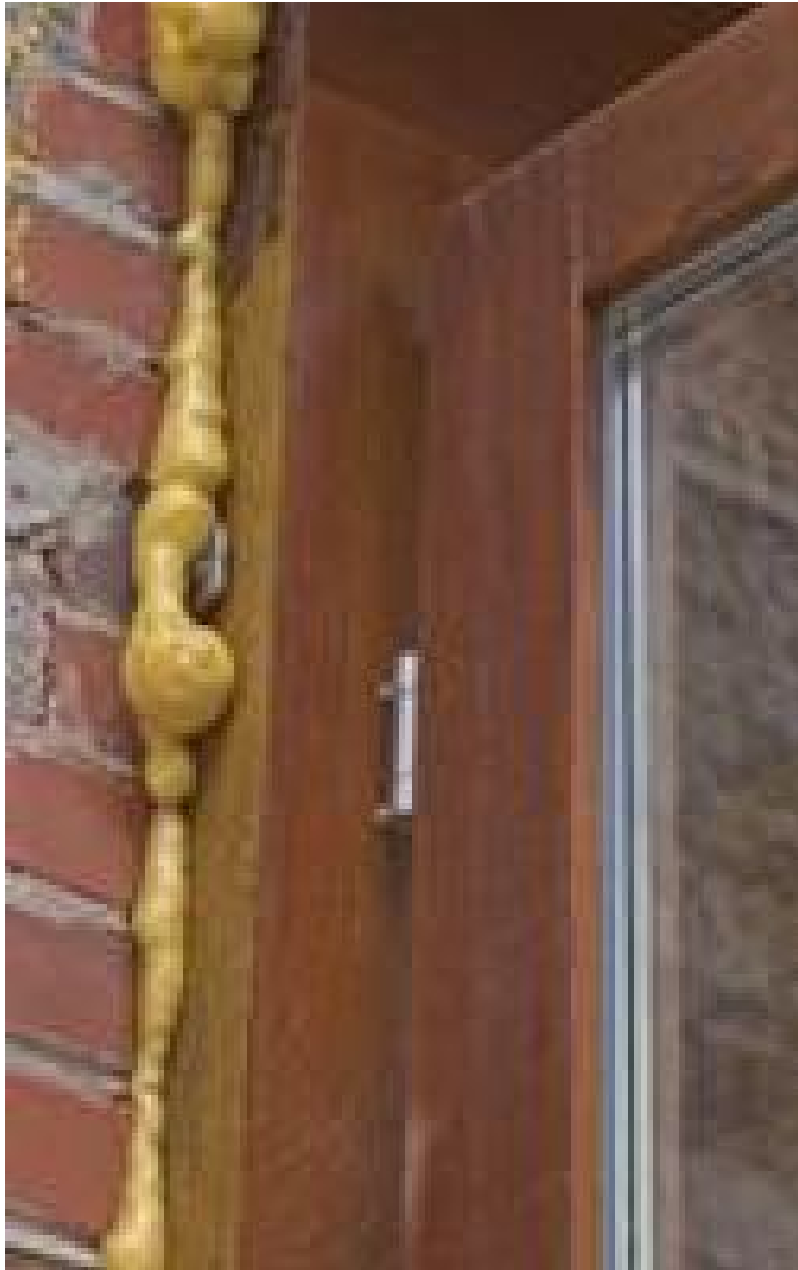
Konventioneller Fenstereinbau mit gesundheitsschädlichem PU-Schaum
