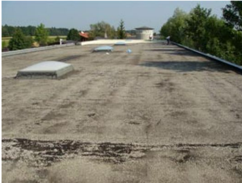
Sanierungsfall Flachdach. Quelle : HPS Polymere Systeme
