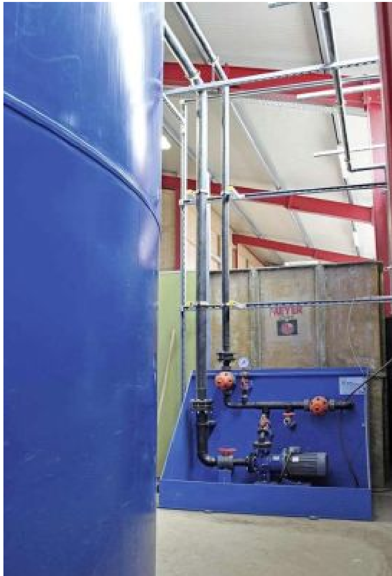
Befüll- und Dosierstationen (bei Bedarf mit Durchflußmessung), Verrohrung der gesamten Chemikalienst
