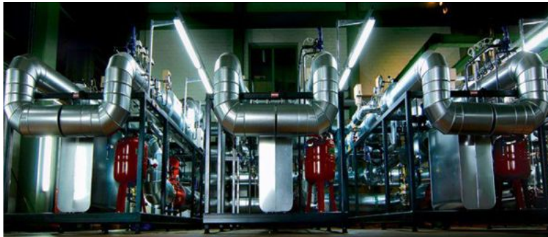
28MW Leistung in der Müllverbrennung anschlussfertig und in Modulbauweise von PEWO hergestellt.
