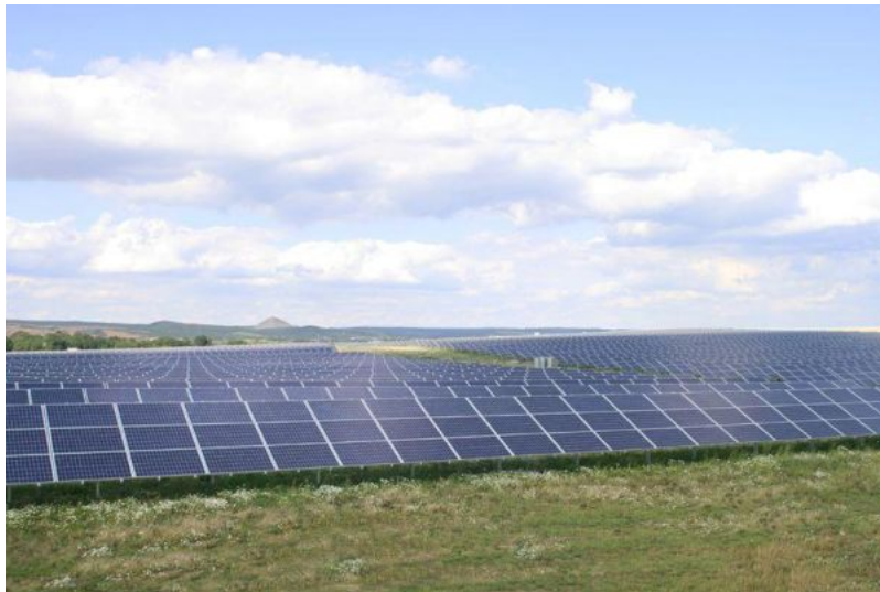
7,3 MW Solarpark in Riethnordhausen
