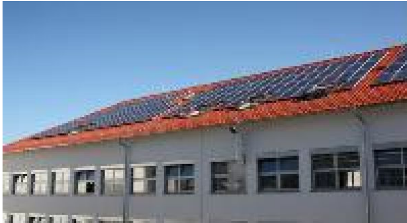
Erzeugen sauberen Strom – Photovoltaikmodule auf dem Bizerba Firmendach
