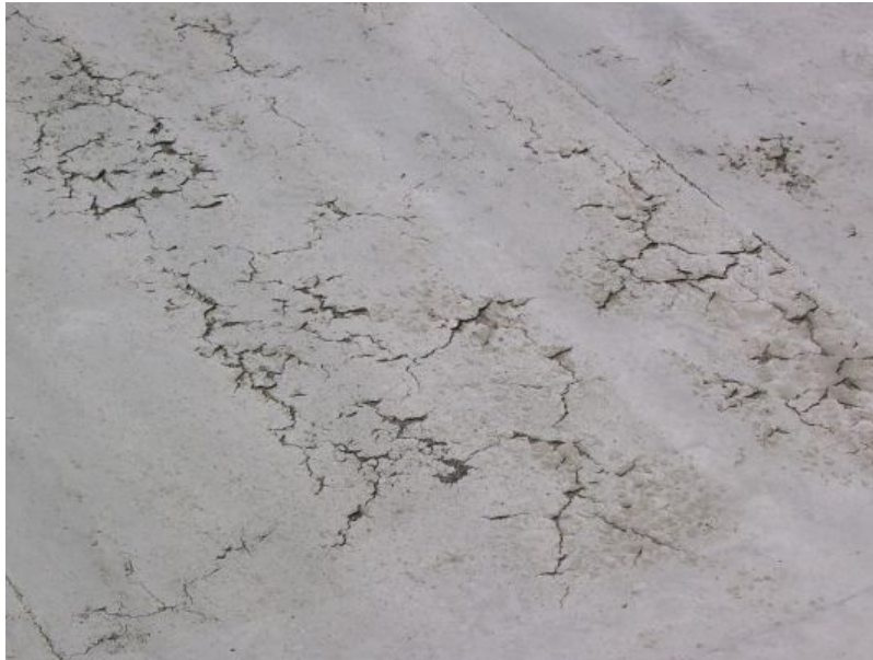
Schadensbild nach Dachreinigung
