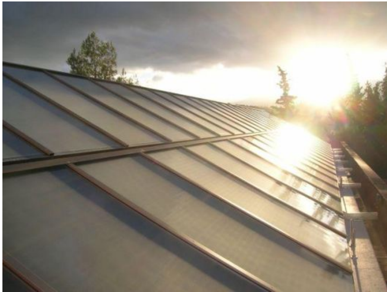
Detailansicht auf die TiSUN Großflächenkollektoren FA am Dach des Hotels Alixares in Granada (ES)
