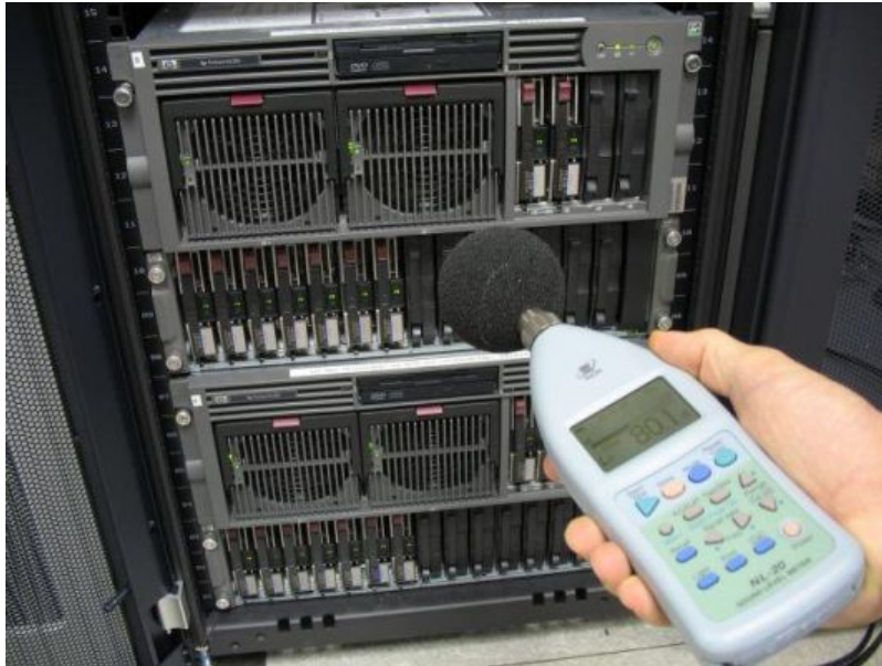
Handschallpegelmessgerät vor Serverschrank, Foto: Joachim Bös
