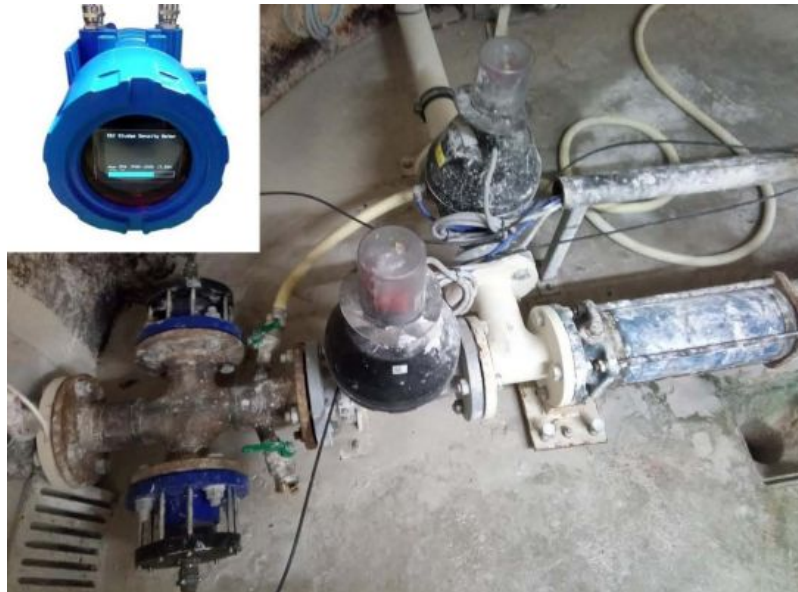
Typische Installation der Schlammdichtemessung im Schlammkreislauf
