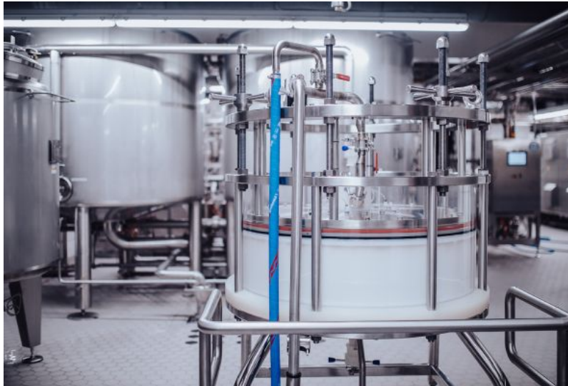
Purifikationskolonne im Werk von Mercurius Production
