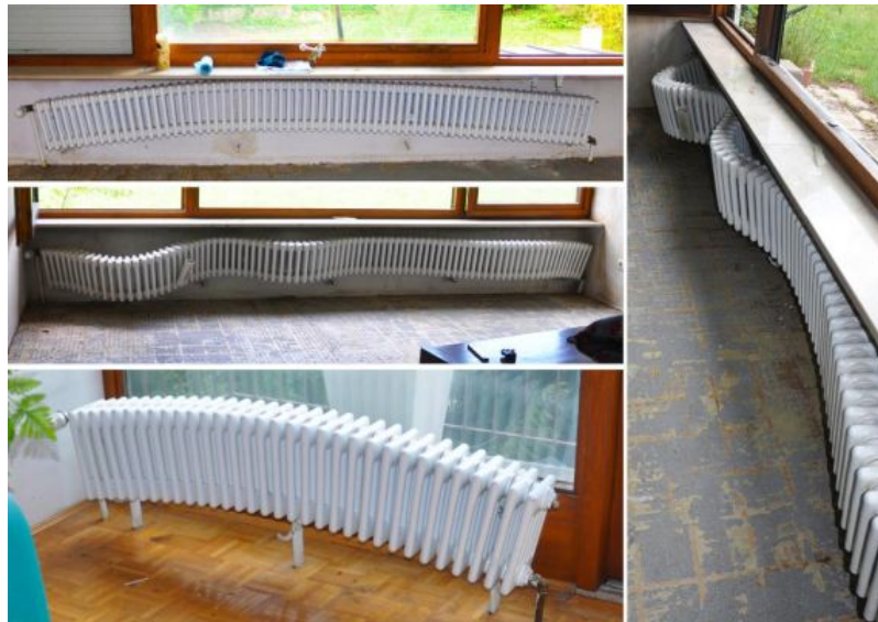
In diesem leerstehenden Gebäude sind die Heizkörper eingefroren und wurden deformiert.
