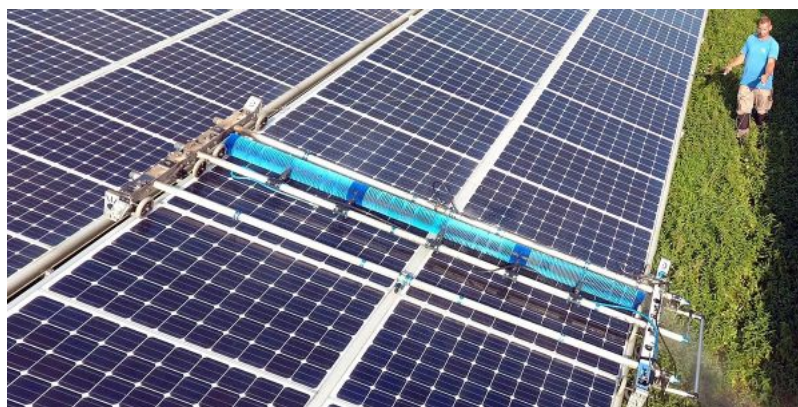
Reinigung PV-Freiflächenanlage mit SOLA-TECS F
