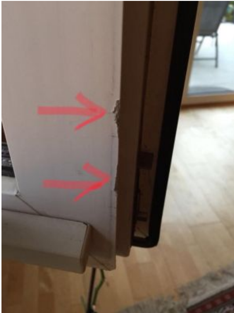
Hebelspuren am Seitenfenster
