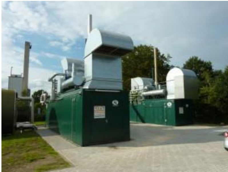
Biogas-BHKW: Kosten senken und Schäden vermeiden
