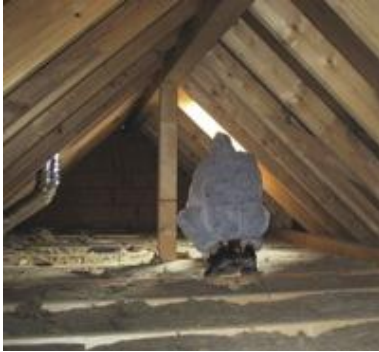
Schimmelpilz im Dachbodenbereich
