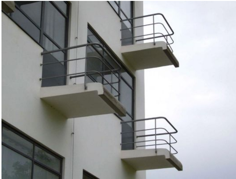
Bei Balkonen muss auf eine funktionierende Entwässerung geachtet werden FOTO: Galinowski / Immowelt.de
