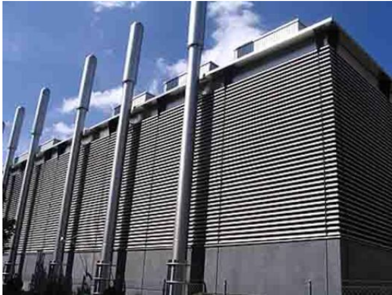
Zu- und Abluft eines Rechenzentrumkomplexes
